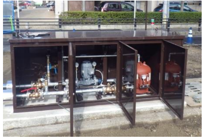
写真-4 循環設備
