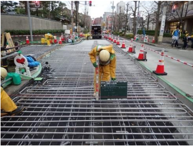
写真-1 放熱パネル
